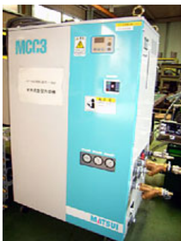
図-4 金型温度制御盤
